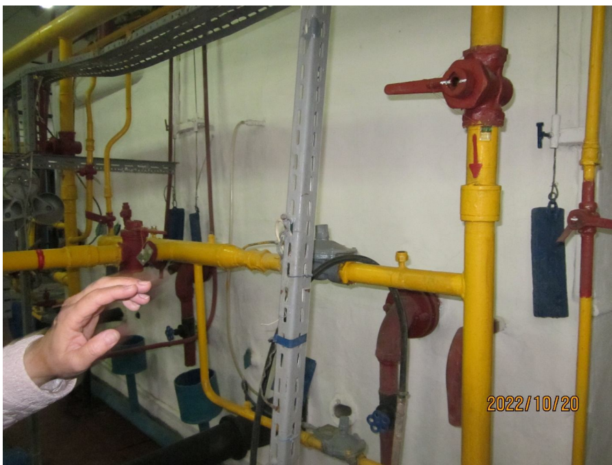
Рис № 0550 подвод газа на оборудование котла.
