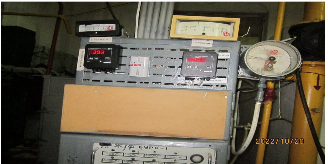
Рис котельная № 1 Система контроля блок автоматики газовой горелки
