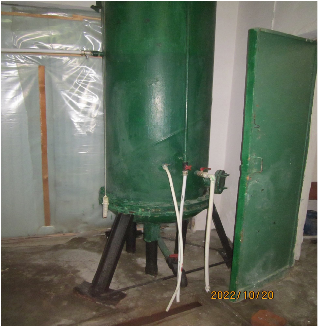
Рис состояние и внешний вид системы водоподготовки котельной № 1.
