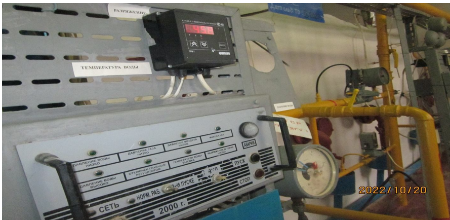
Рис-057 система контроля за работой газового оборудования Состояние удовлетворительное.
