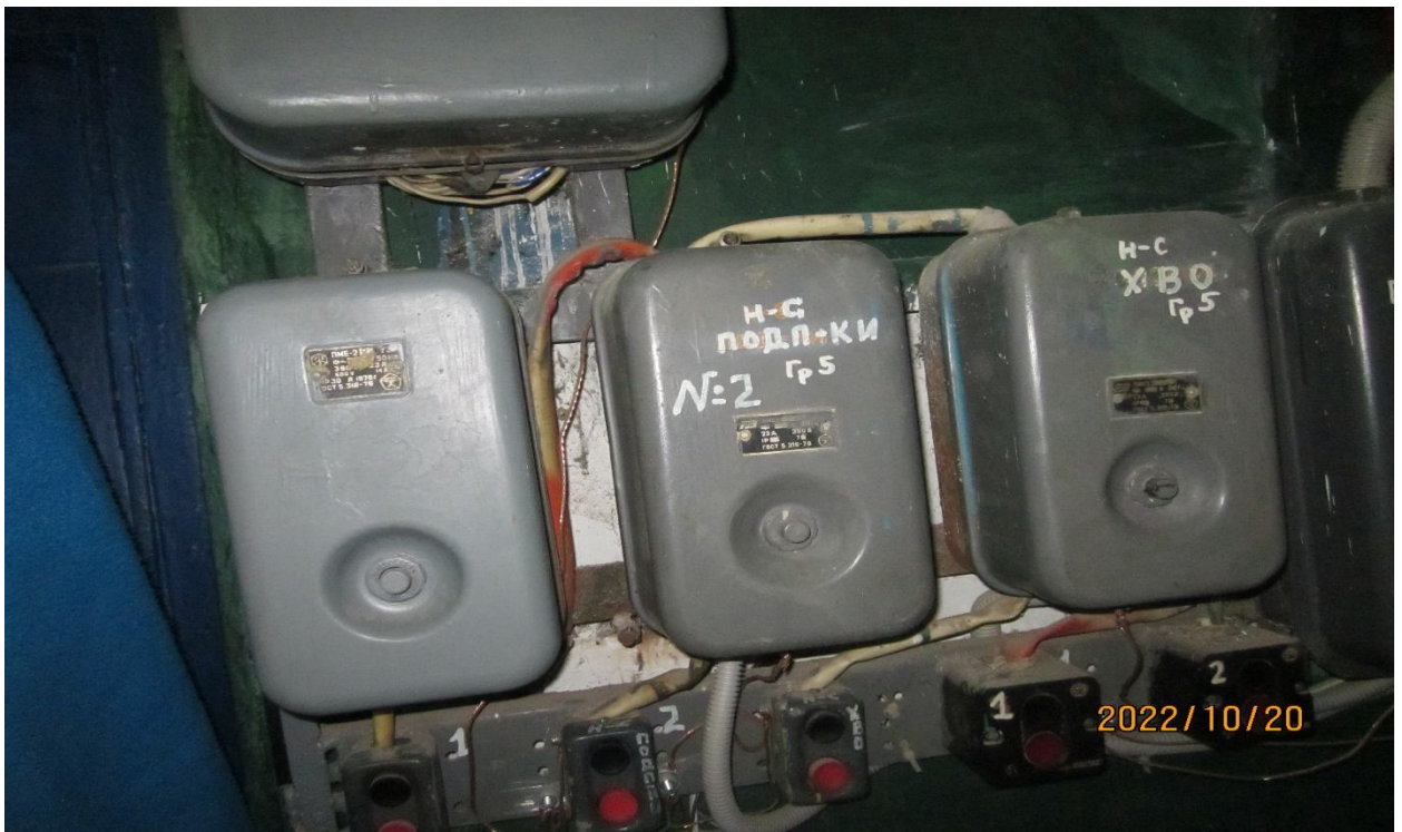
Рис Состояние и внешний вид блока управления системы отопления котельной № 1. Состояние удовлетворительное.
