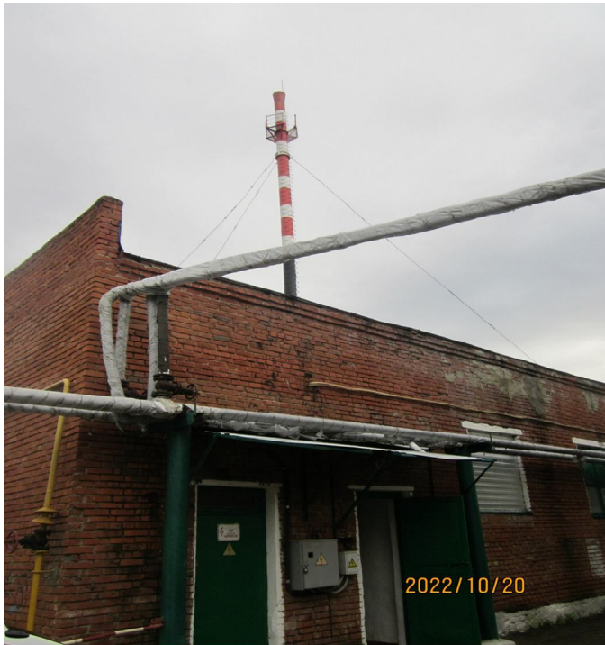
Рис № 0541 Котельная по ул Советская состояние и внешний вид теплотрассы удовлетворительное
