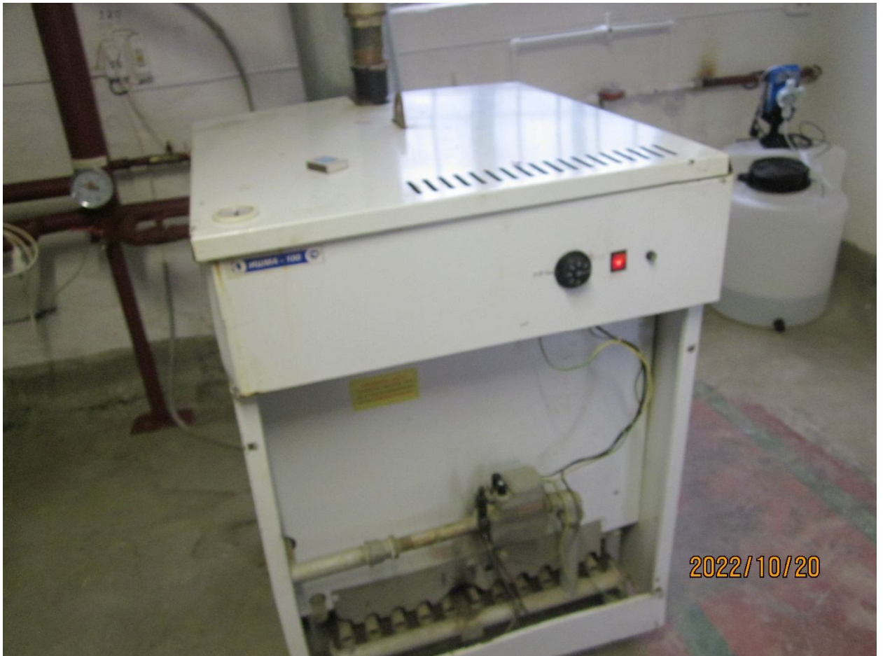
Рис Состояние и внешний котлов Котельной по ул Эскадронная
