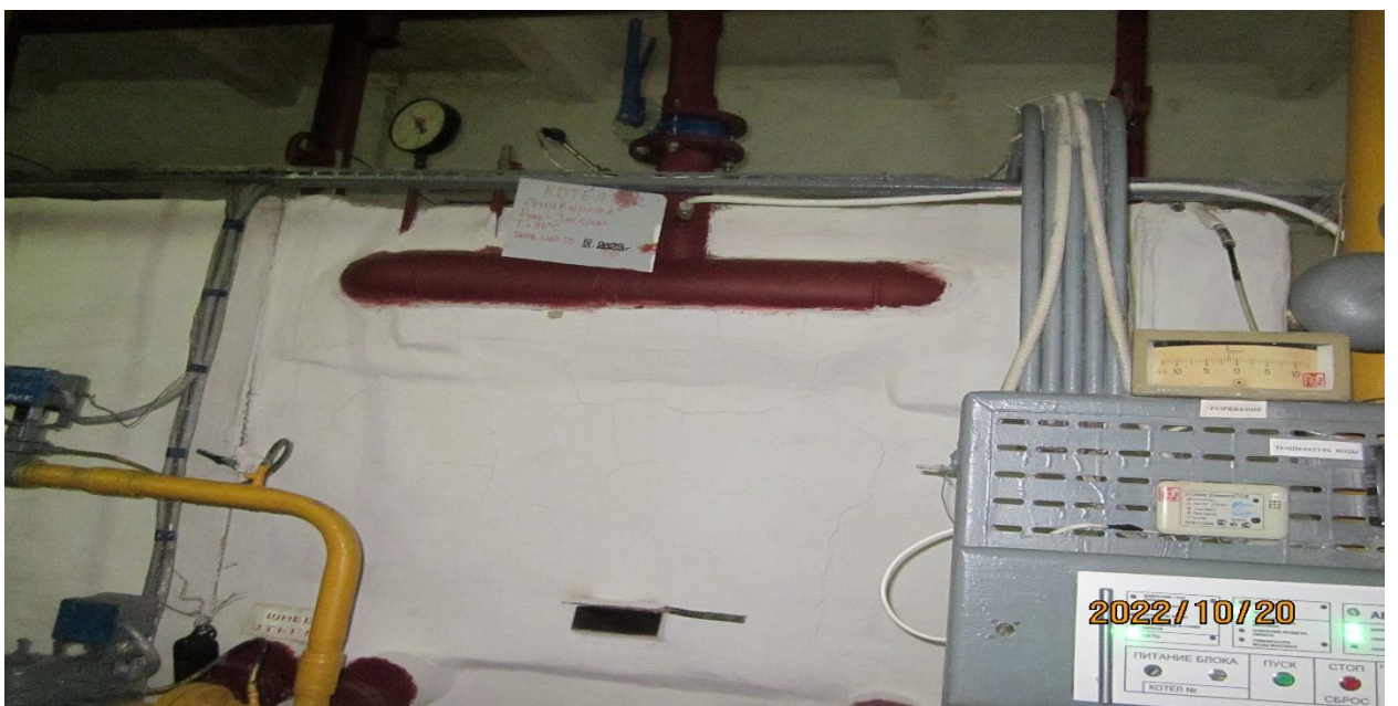
Рис-2 Котел КС-1.95. газовая горелка старого образца.
