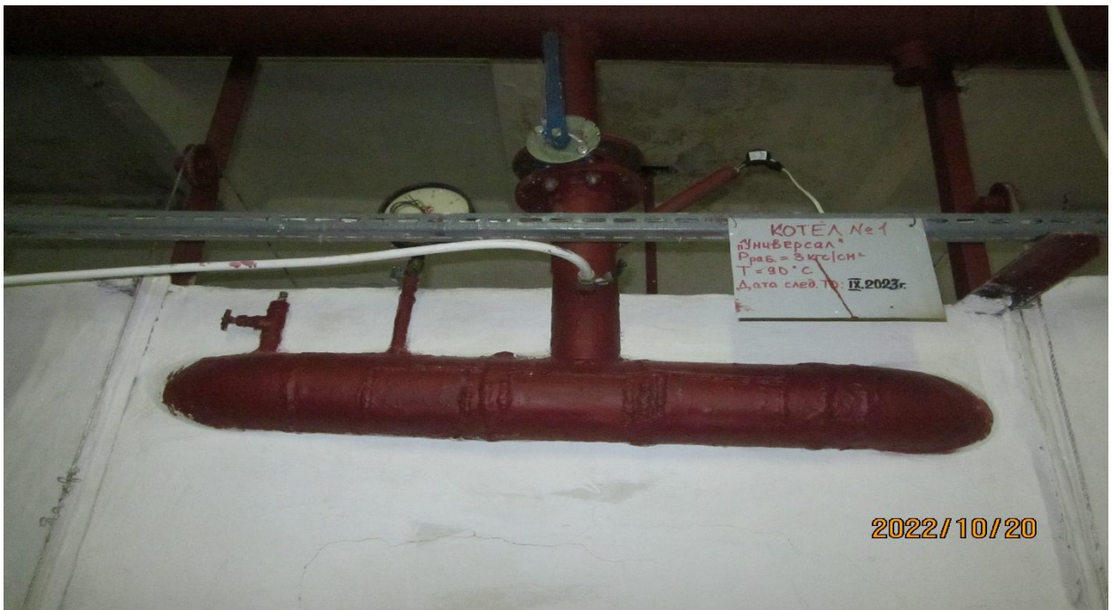
Котел Универсал Котельной № 1 Состояние удовлетворительное но требует замены.
