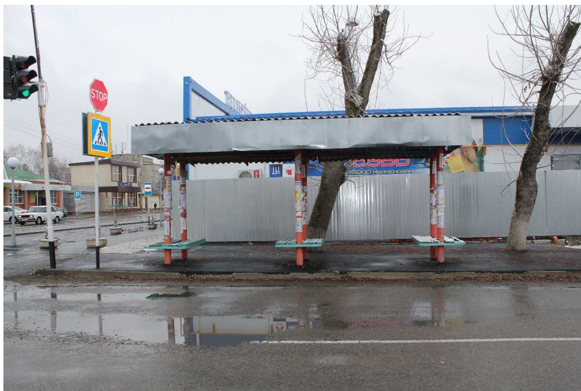
Состояние и внешний вид остановки № 13 улица Набережная
