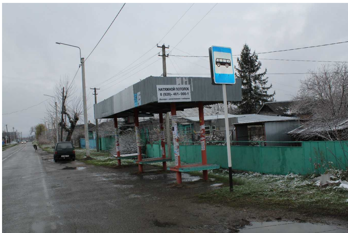
Состояние и внешний вид остановки № 14 улица Набережная
