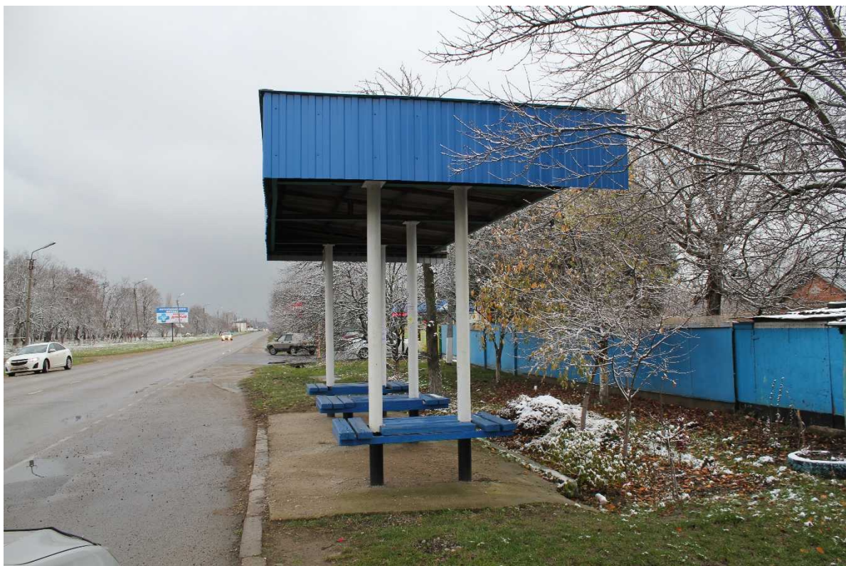
Внешний вид и состояние инфраструктуры остановки № 30
