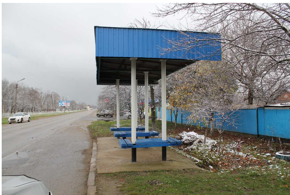
Внешний вид и состояние инфраструктуры остановки № 28
