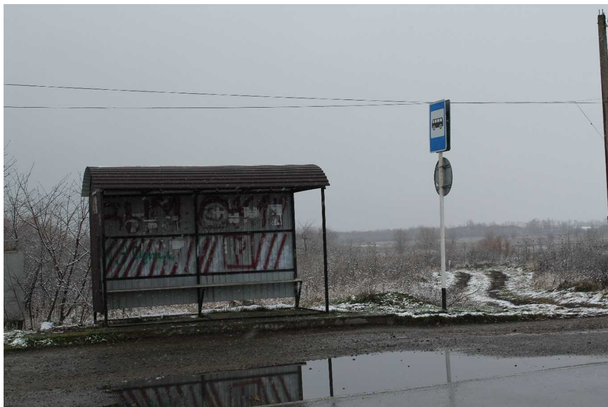
Состояние и внешний вид остановки № 12 улица Набережная
